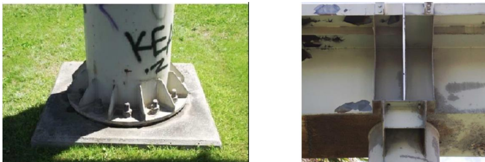
Figura 2. Pormenores estruturais. Apoio do pilar central (esq.) Apoio das vigas no pilar central (dir.)
