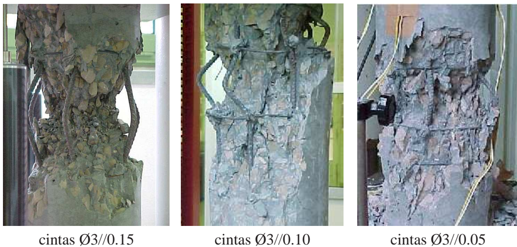
Figura 5.16: Pormenores da rotura dos modelos de betão armado
