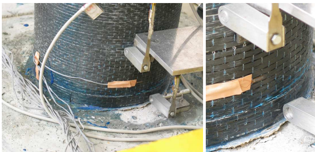
Figura 6.11: Pormenores da fendilhação observada no pilar P10
