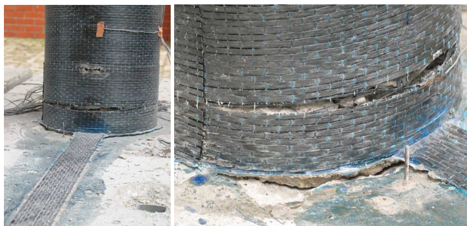
Figura 8.12: Pormenores das fendas e da rotura do reforço longitudinal do pilar P9
