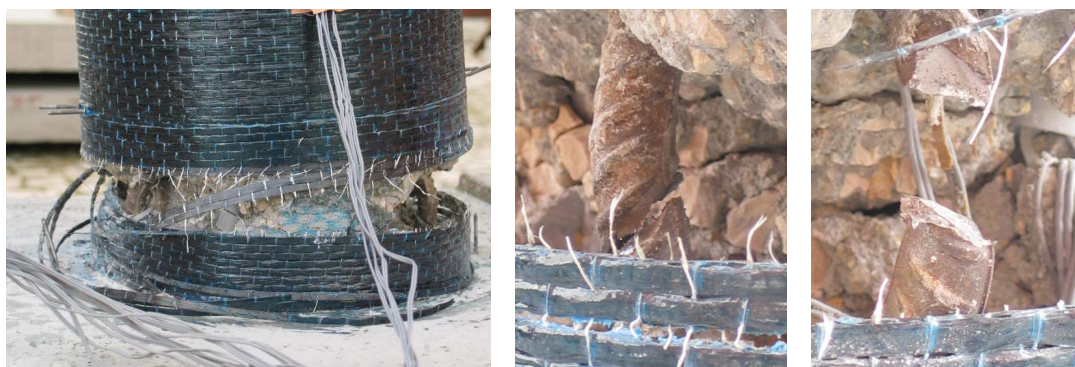
Figura 8.7: Pormenores da rotura dos varões de aço no pilar P3R
