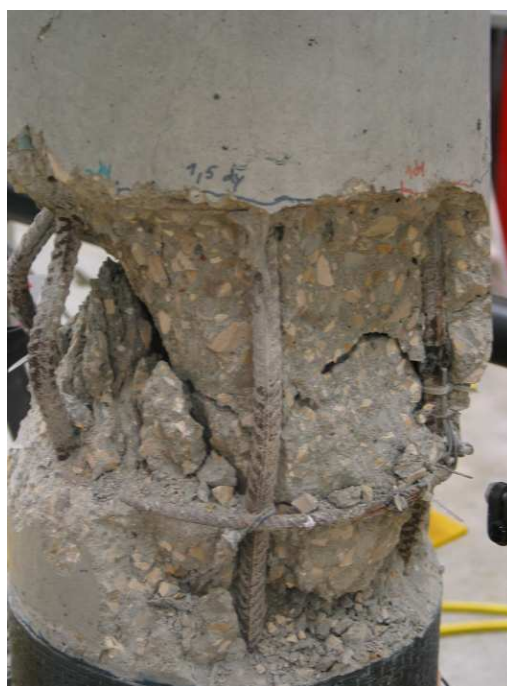
Figura 8.8: Pormenor da abertura da cinta e correspondente encurvadura dos varões longitudinais do pilar P4
