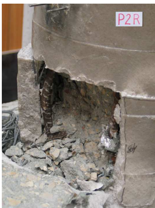
Figura 8.6: Pormenor da encurvadura dos varões e da rotura do betão polimérico na base do pilar P2R
